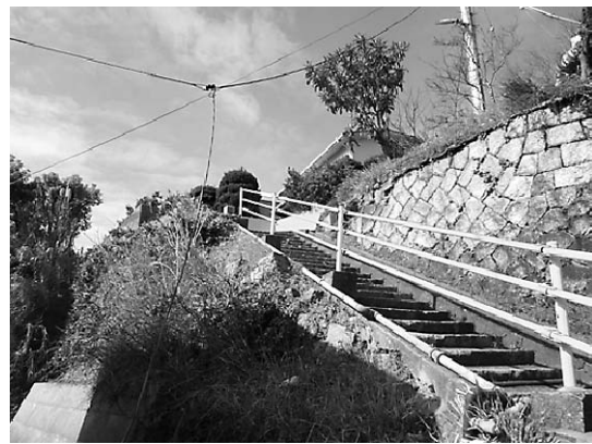
手摺が設置された階段 ほとんどの階段に手摺が設置されているが、夜間の帰宅時などで落下事故が度々起きている
